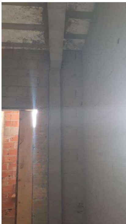
Figura 21 – Apresenta a incompatibilidade encontrada no Ponto 3 em campo.
