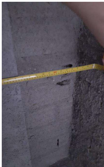
Figura 17 – Apresenta a incompatibilidade encontrada no Ponto 1 em campo.
